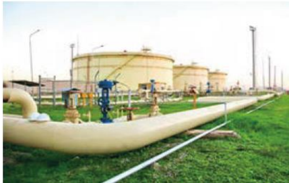
شکل ۲۰- نمایی از خطوط انتقال سوخت
