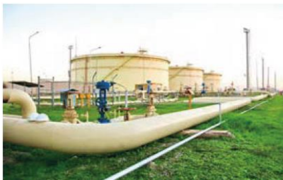
شکل ۲۰- نمایی از خطوط انتقال سوخت
