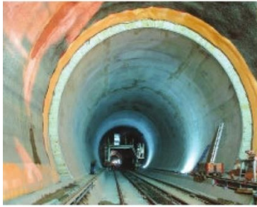
پوشش داخلی تونل به وسیله قطعات بتن
